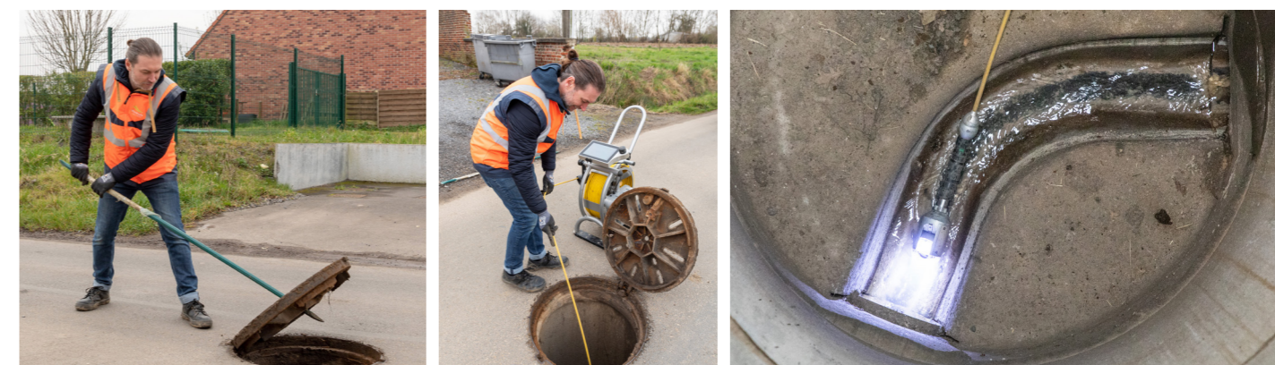
Inspection d'une canalisation par caméra afin de déceler l'arrivée d'eaux claires dans le réseau d'assainissement
